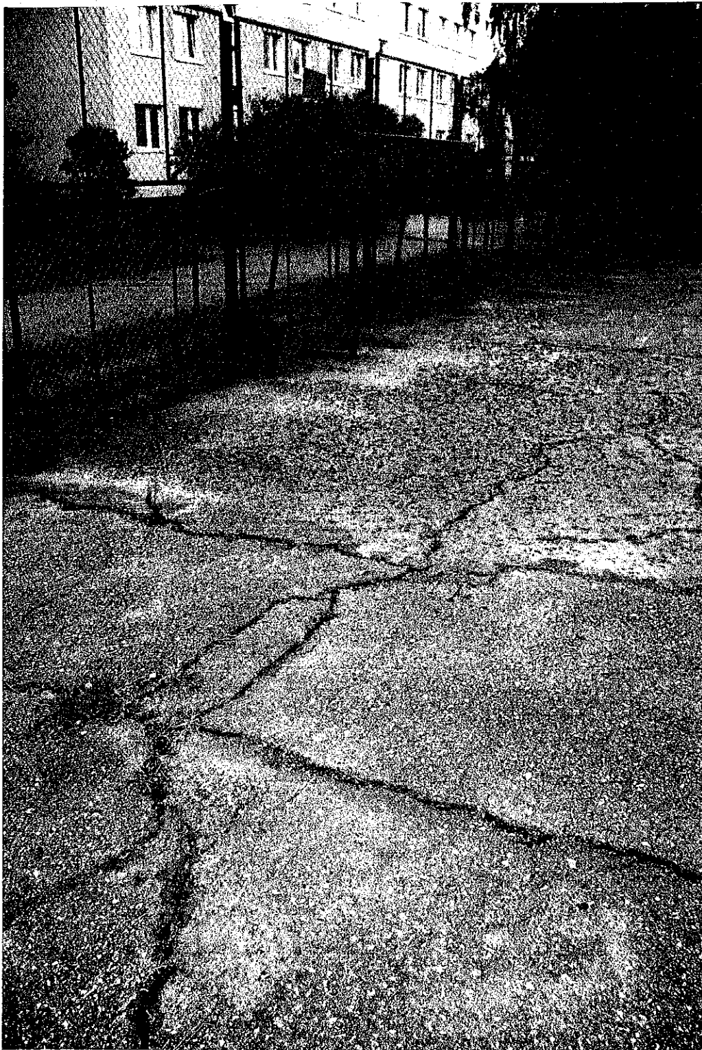
Zdjęcie nr 2. Stan nawierzchni
