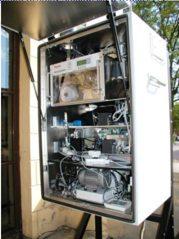
Wnętrze stacji pomiarowej
