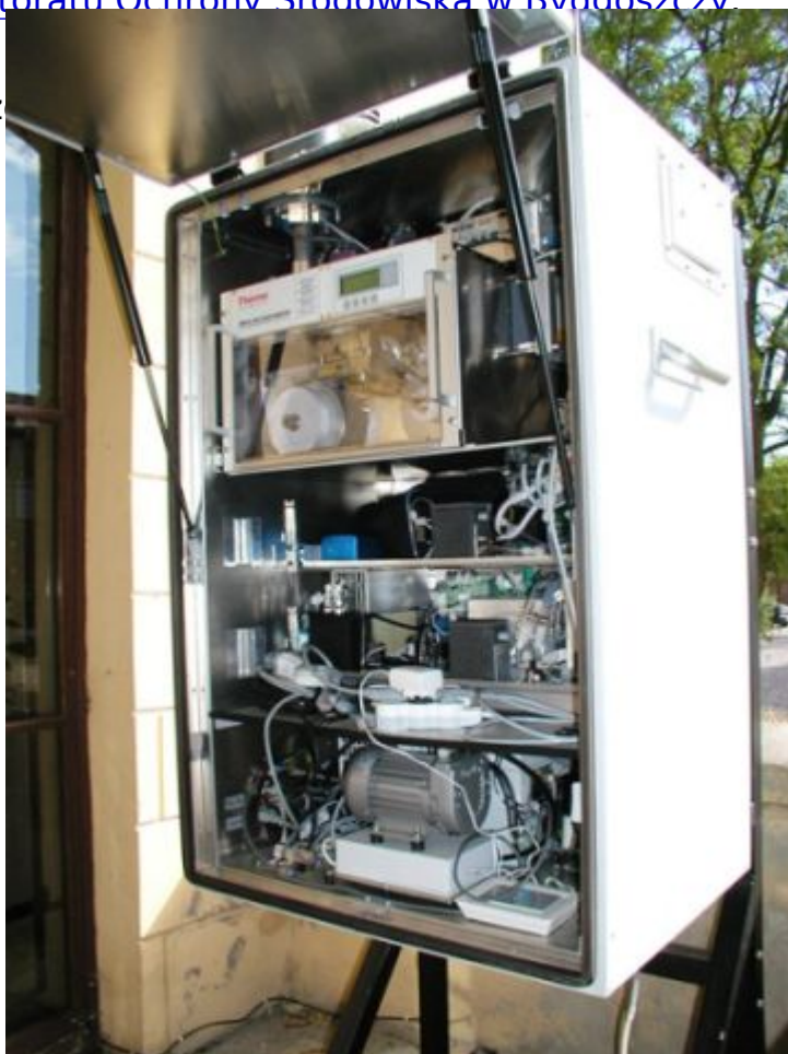
Wnętrze stacji pomiarowej
